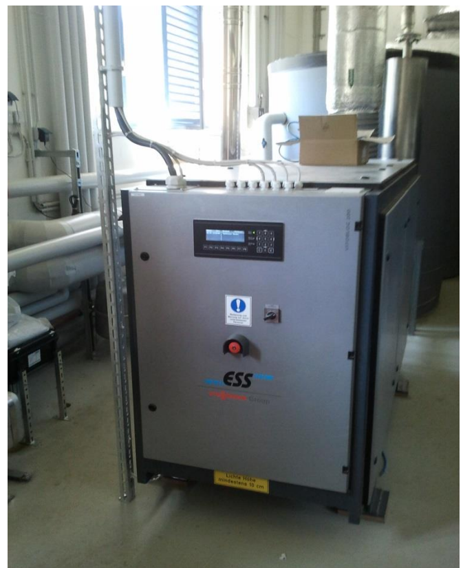
Abbildung 2: Blockheizkraftwerk mit Pufferspeicher im Hintergrund
