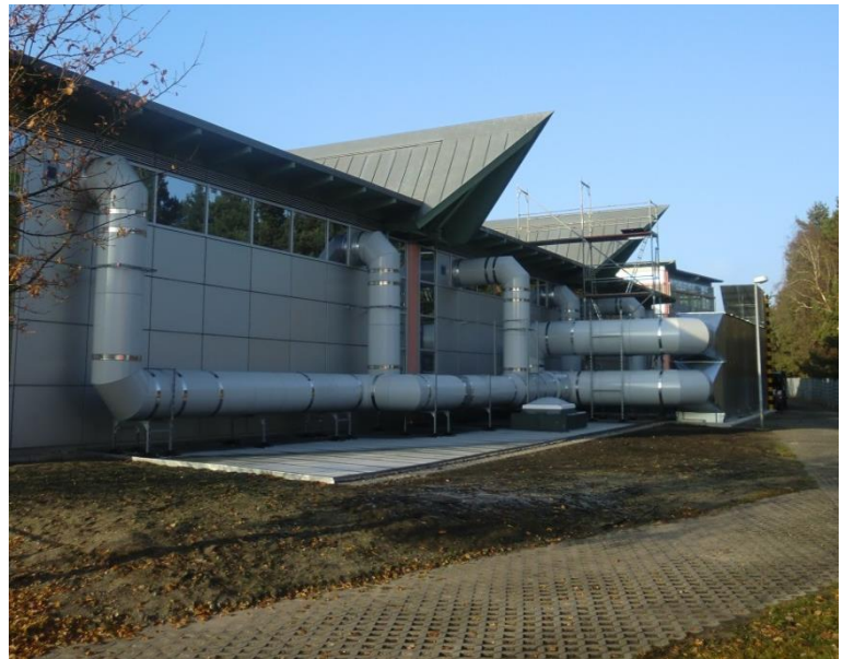
Abbildung 1: Außenansicht der Lüftungsanlage der Sporthalle des BSZ „Konrad Zuse“
