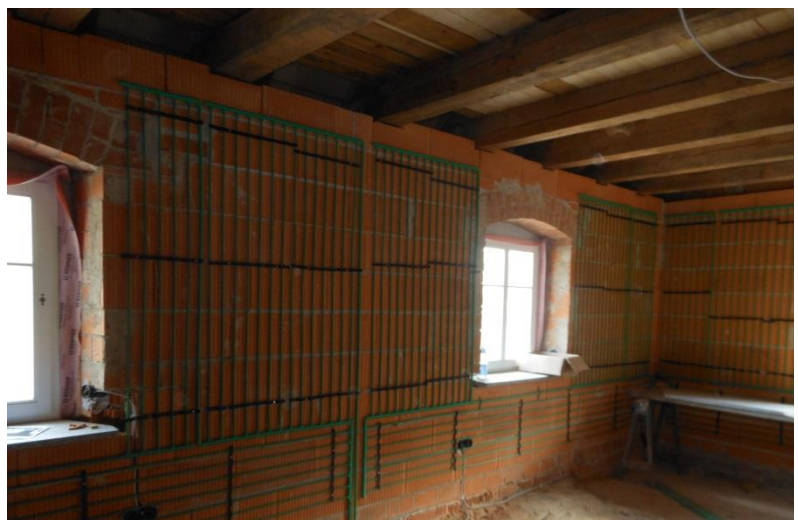
Abbildung 2: Anbringung des Flächentemperiersystems an der Innenwand
