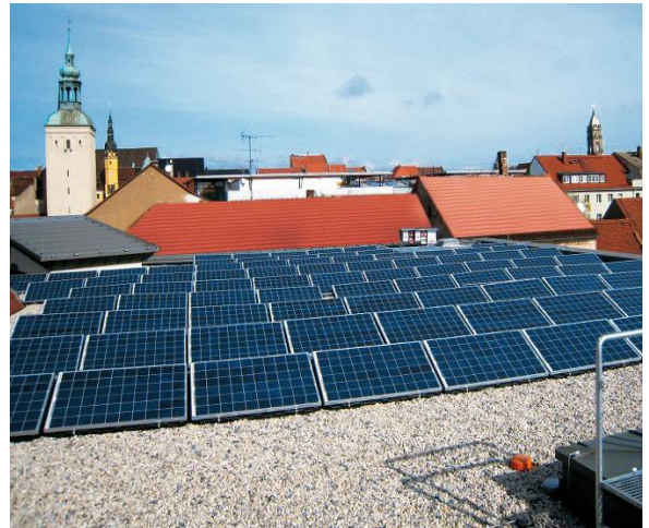
Abbildung 5: Photovoltaikanlage auf dem Dach von INTERSPORT TIMM
