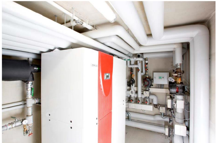
Abbildung 2: Technikraum mit Wärmepumpe
