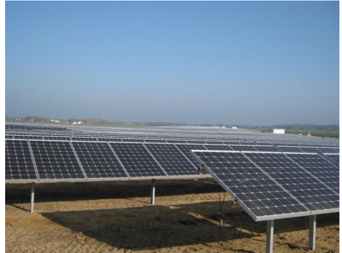
Abbildung 2: Photovoltaikanlage in Kamenz
