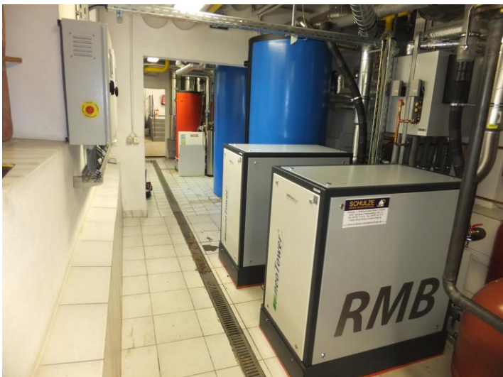
Abbildung 2: 2 x BHKW neoTower 20.0 der RMB/Energie GmbH mit nebenstehendem Pufferspeicher
